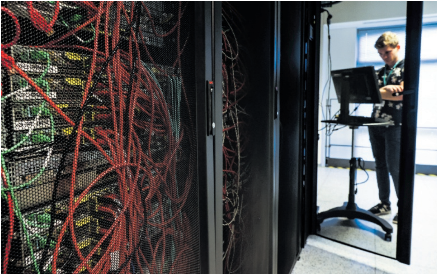
Sala de servidores en la sede de Cisco Systems de Cracovia. BEATA ZAWRZEL (NURPHOTO/GETTY IMAGES)
