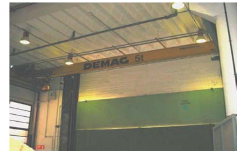
Pont grua DEMAG
