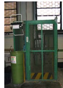
Muntacàrregues a la Planta S1
