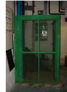
Muntacàrregues a la Planta S2
